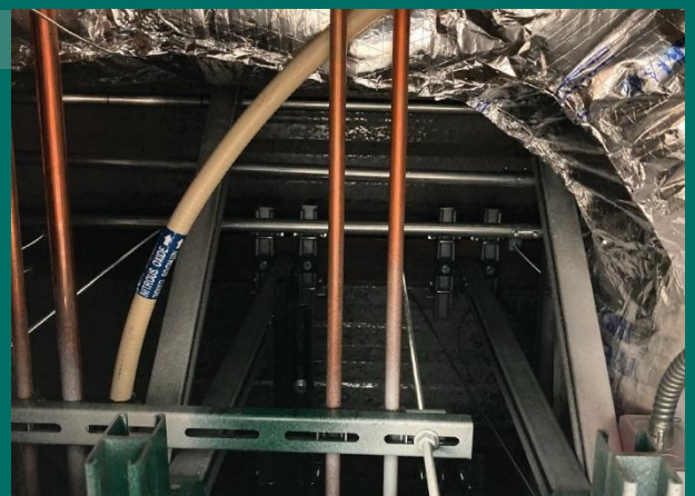
MediTrac® CMT oberhalb der fertigen Decke eines OP-Saals
