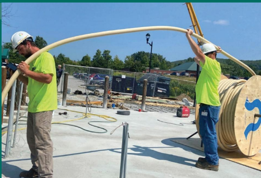
Unterirdische Sauerstoffhauptleitung für eine medizinische Einrichtung
